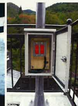
非常用コンセント(右)
